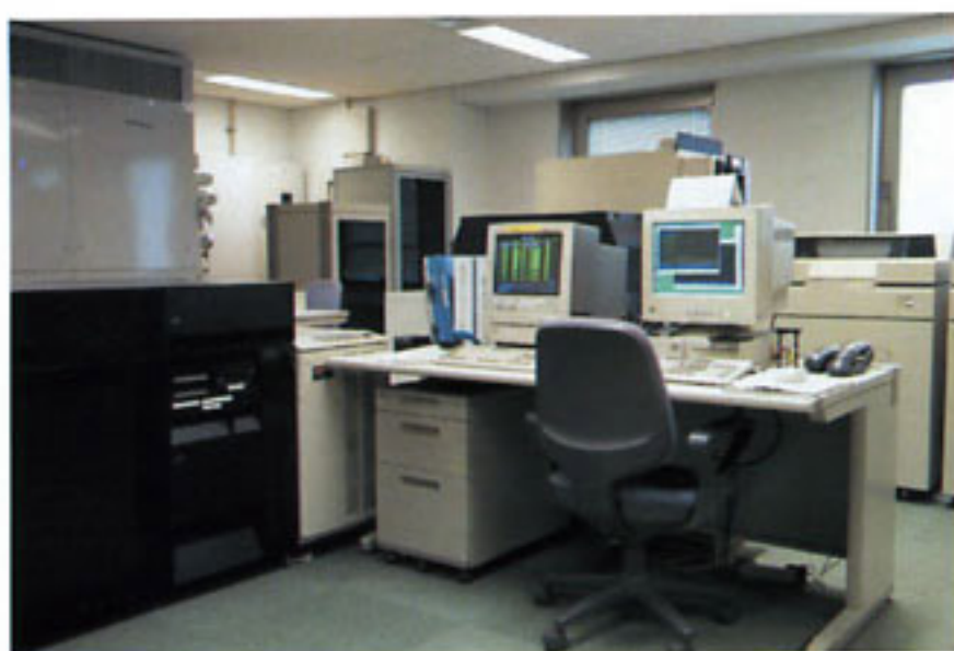
地方局マシンルーム
