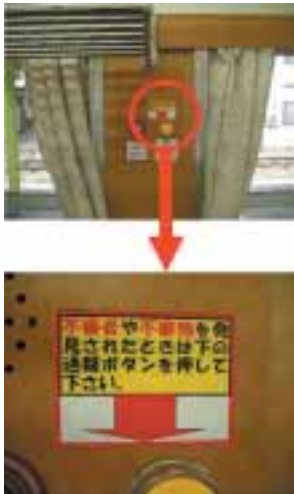
(写真2) 車内に設置されている通報器。通報事由として、「不審者や不審物を発見されたとき」と下部に表示がある。(甘木鉄道)
