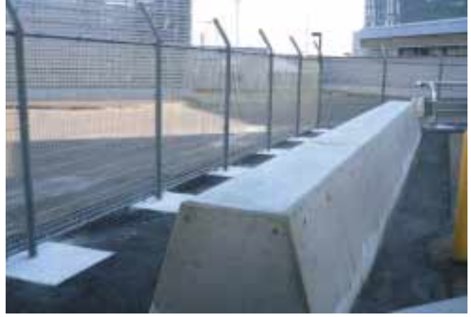
ガードレール等の設置拡充(車の侵入対策)
