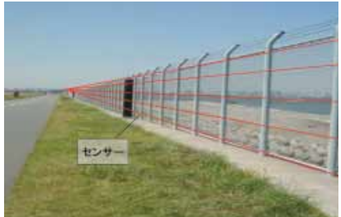
センサーの設置拡充(人の侵入対策)
