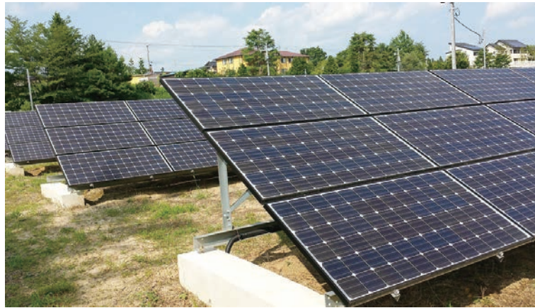
図5 中学校跡地を利用した太陽光発電所
