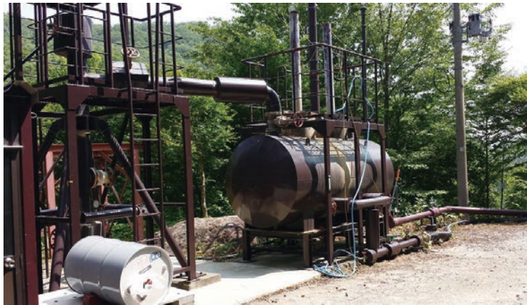
図4 バイナリー発電装置が設置される16号源泉の貯湯槽
