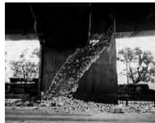
【兵庫県南部地震による橋脚の被災】
