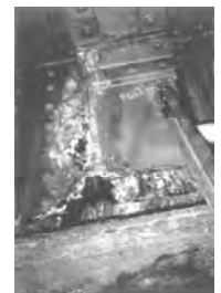
【鋼桁の著しい腐食】
