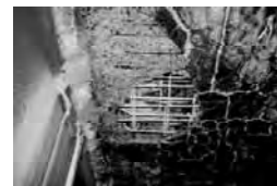
【コンクリート床版の抜落ち】
