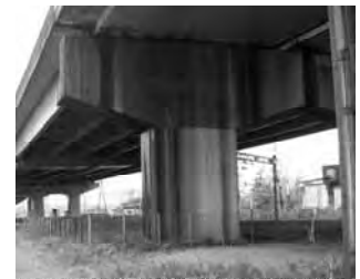
【耐震補強の実施により新潟県中越地震では甚大な被害無し】
