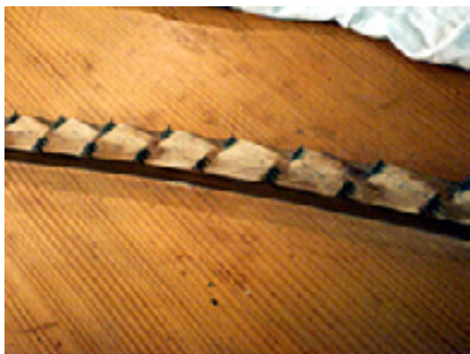
錆を取った状態
