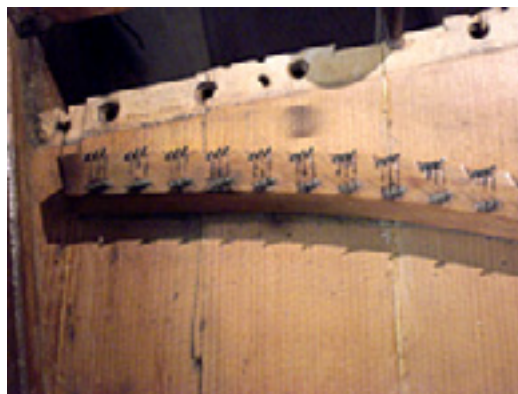
高音部のブリッジ上の錆(作業前)
