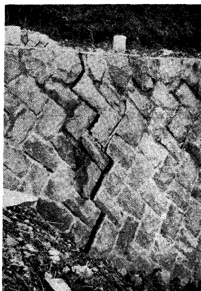
写真-4 大地々区道路擁壁のキ裂
