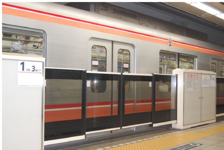
図12 九段下駅に試行導入された大開口ホーム柵
