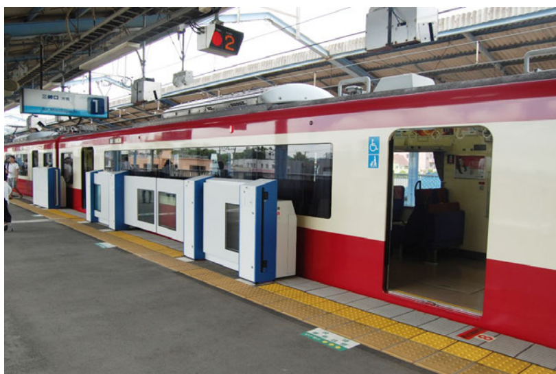
図9 三浦海岸駅に試行導入されたマルチドア対応ホームドア（車両が 2 扉の場合）
