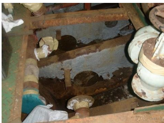
図5 機関室フレーム (補強前)
