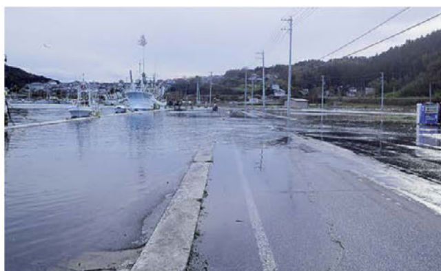
地盤沈下の影響で高潮時には道路が冠水
