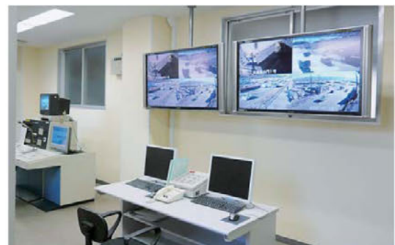
遠隔制御操作卓
