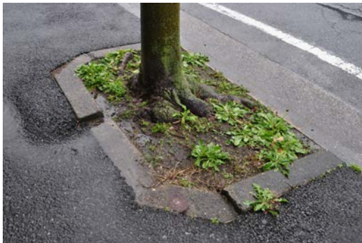
アオギリの根上がり状況
