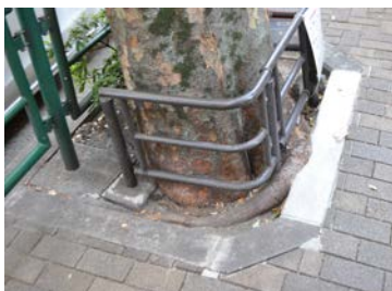
根株による植樹帯の損傷
