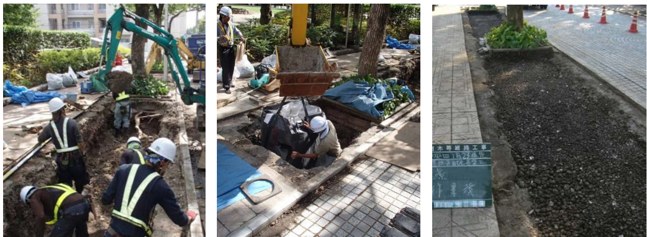
根系誘導耐圧基盤設置状況（左から、掘削 → 敷き均し → 転圧完了）
