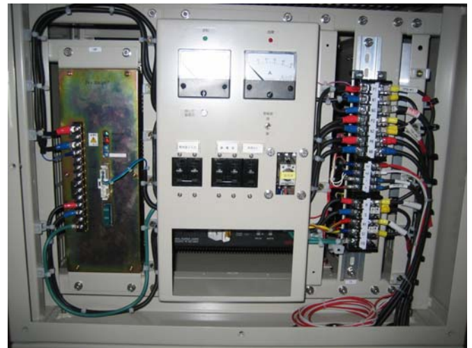
図5 直流電源装置外観
