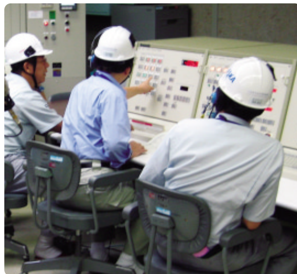
点火タイマ管制装置
