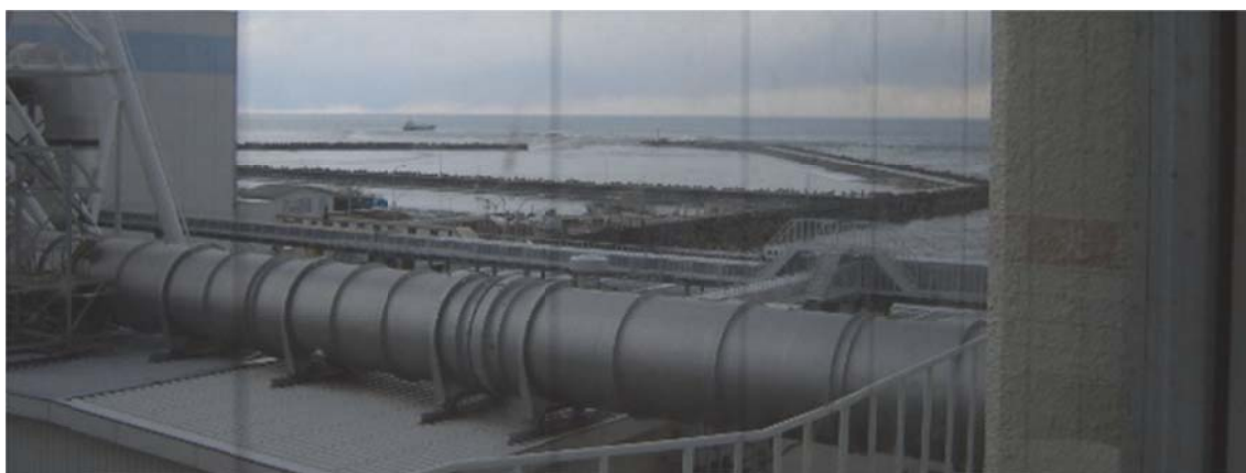
写真2.2.3-1 (exif情報上の撮影時刻は15時41分25秒) 東電より提供
