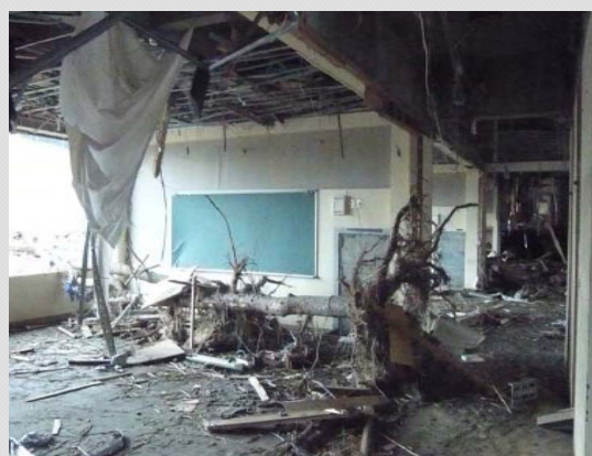
水圧による壁の喪失
