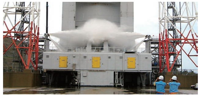
図4 音響低減用冷却水設備 追加した冷却水設備の作動状況を示す。
