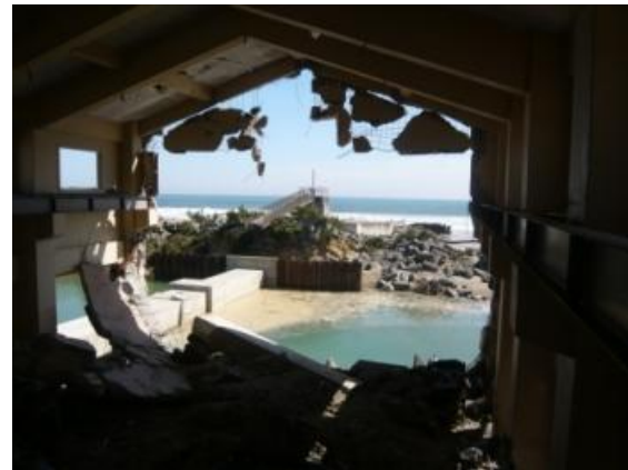
被災後 建物内部から海側
