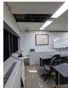
図 天井板の落下(工学院大学)
