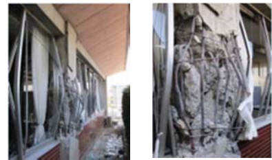
市役所本庁舎の被災状況
