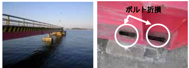
宮城海上保安部 船艇基地の被害状況
