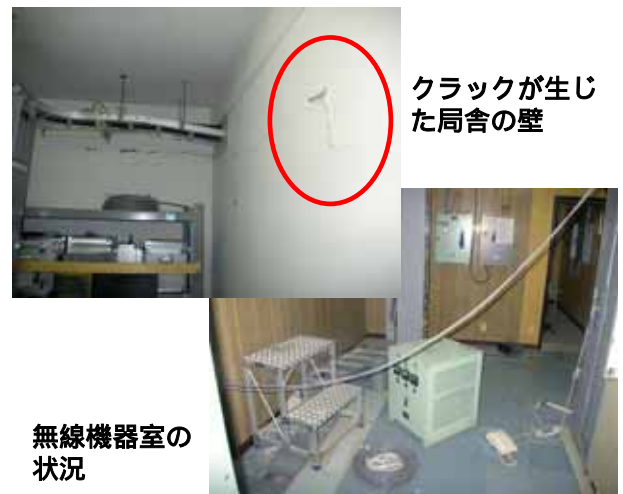
駒ヶ峯受信所の被害状況
