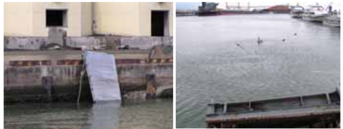
石巻海上保安署 船艇基地の被害状況
