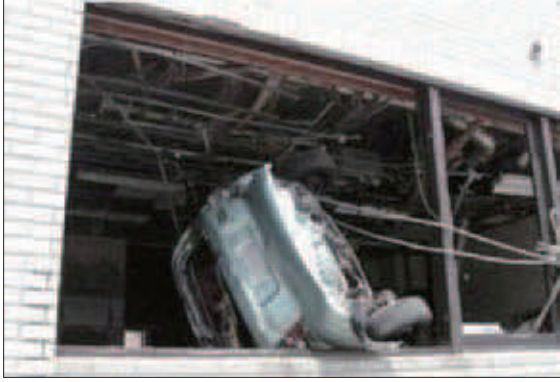
写真④-1 被災当時の女川町生涯教育センター（宮城県図書館提供）
