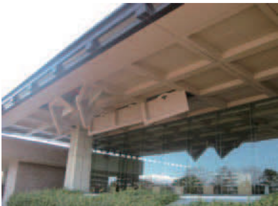
写真⑦-1 福島県立図書館 被災当時の天井パネル（福島県立図書館提供）
