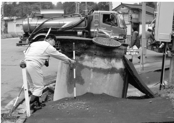
集落排水のマンホール浮上（柏崎市）
