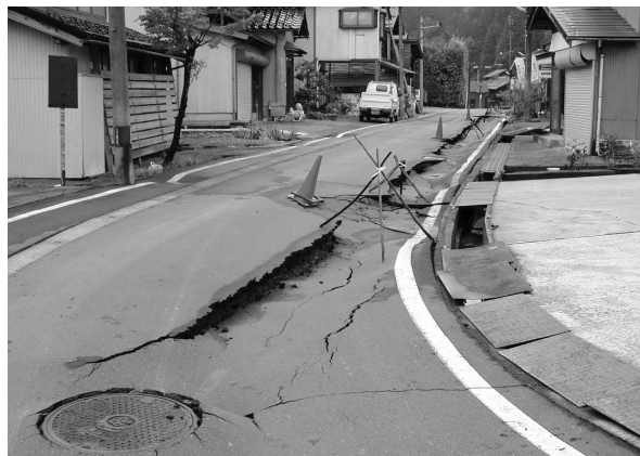
同じく管路の沈下状況（柏崎市）
