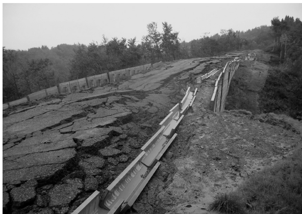
広域農道の被災状況（魚沼市）
