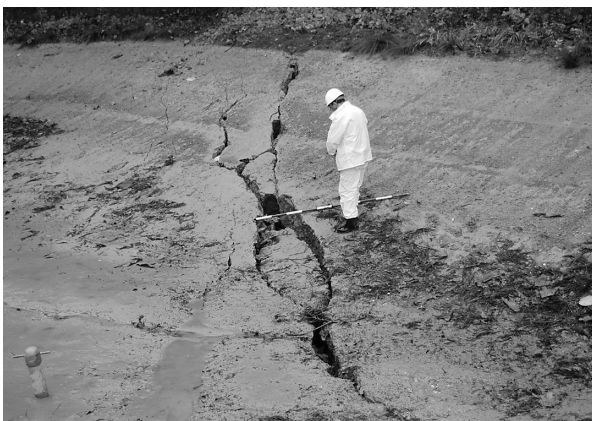
ため池内に生じた亀裂（長岡市）
