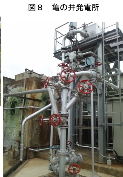
図8 亀の井発電所 (注) 湯けむり発電設備は、温泉井戸のすぐ上に設置され、上部の箱の中に収まっている。 (出典) 平成26年10月1日筆者撮影。
