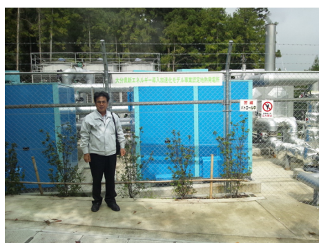
図2 五湯苑地熱発電所
