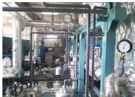
図4 機器・配管が並ぶ建屋内
