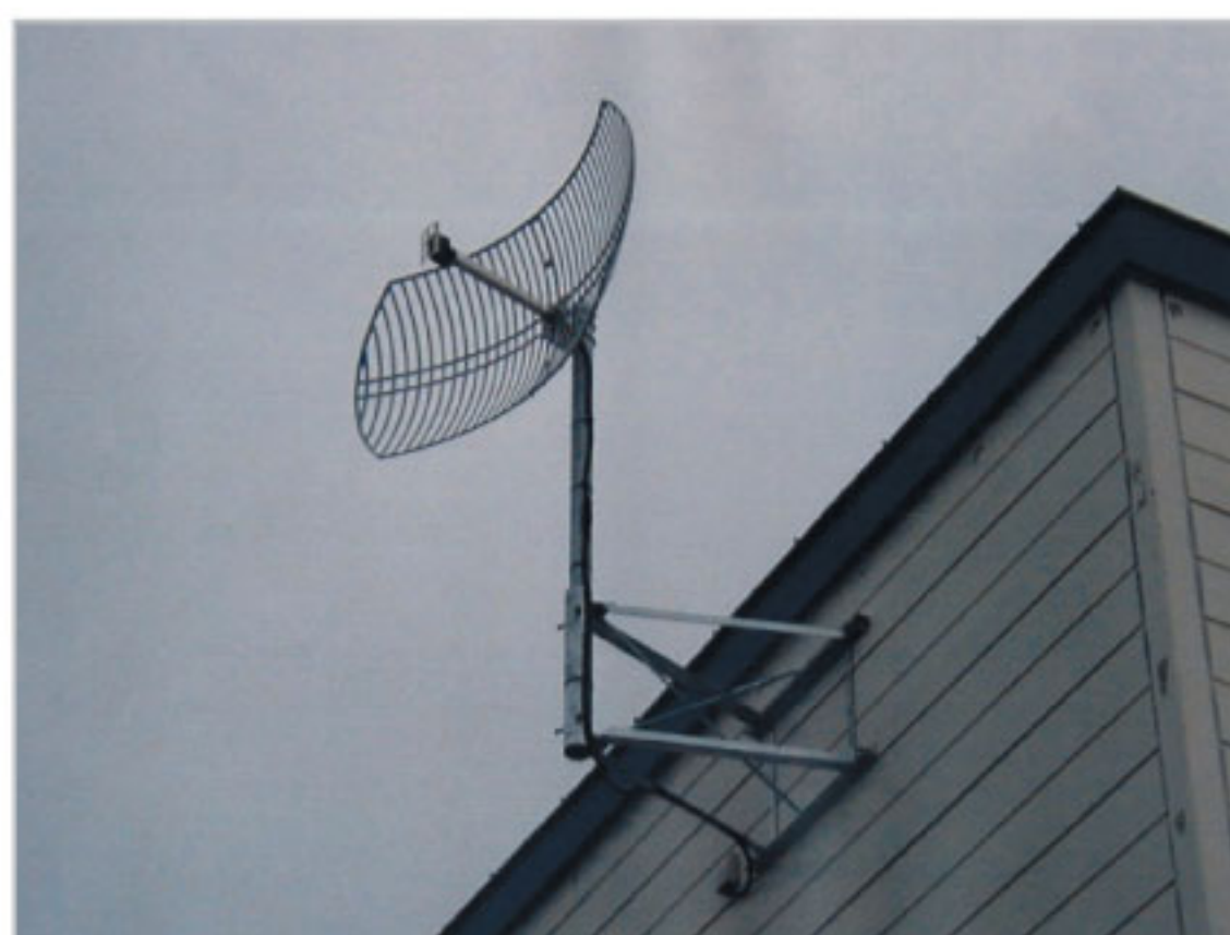
図12 宗谷中学校に設置した長距離無線LANパラボラアンテナ
