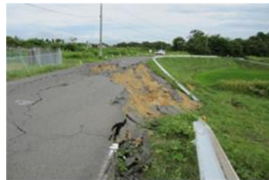
写真3 農道の法肩崩壊
