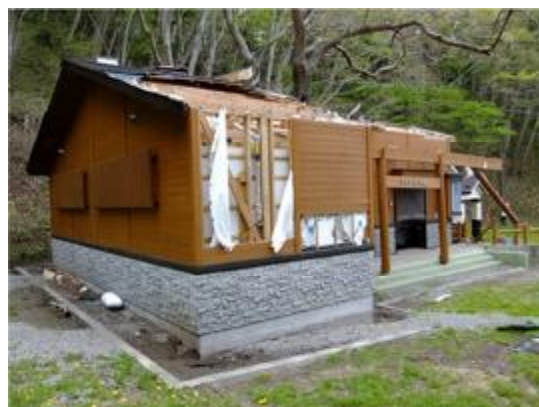
<被災した休憩所兼シャワー室（山田町船越）>
