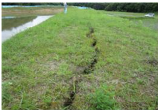
写真1 ため池堤体のクラック
