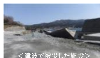
<津波で被災した施設>
