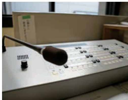
館内放送の放送室
