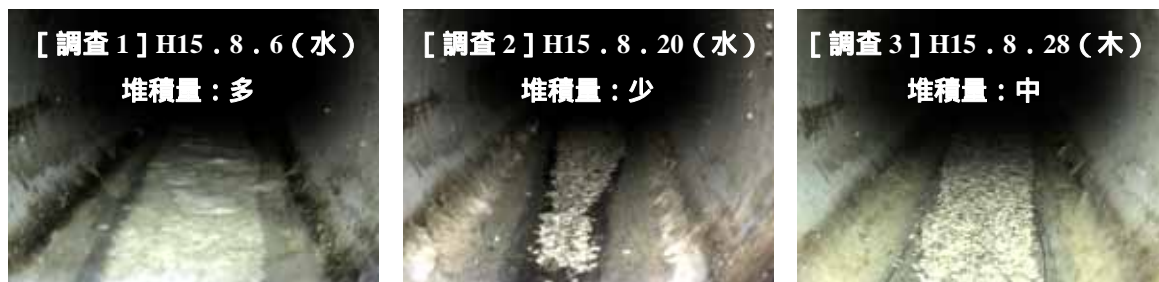
写真 4.7.2 管渠内の堆積状況 (調査地点 ,平成 15 年 8 月実施分)
