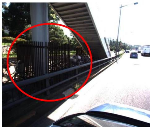
図 20 設置目的が不明確な柵・壁の例
