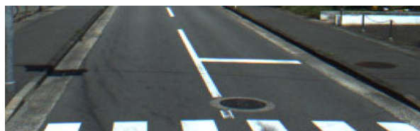
車線と路肩との境界が路面の色彩で明確であり、 車道外側線が省略された例
