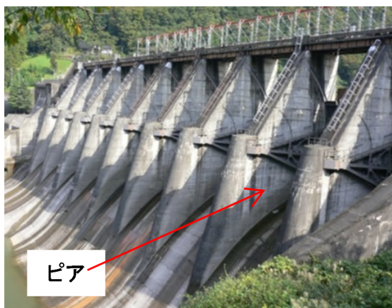
図 2.1 ラジアルゲート洪水吐ピアの例 （北陸電力(株)神通川第二ダム）
