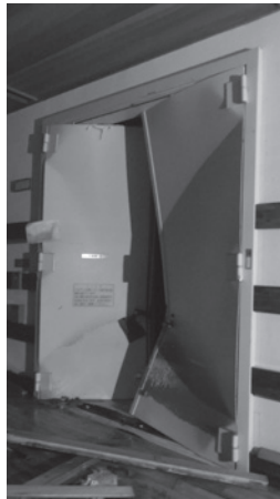
図3 水圧により破壊された第3収蔵庫の扉
