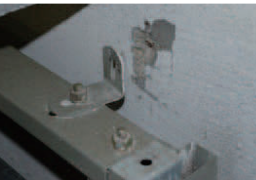
写真2 アンカーボルトが化粧材に留まって構造体に達していなかったため、簡単に抜けてしまった例
