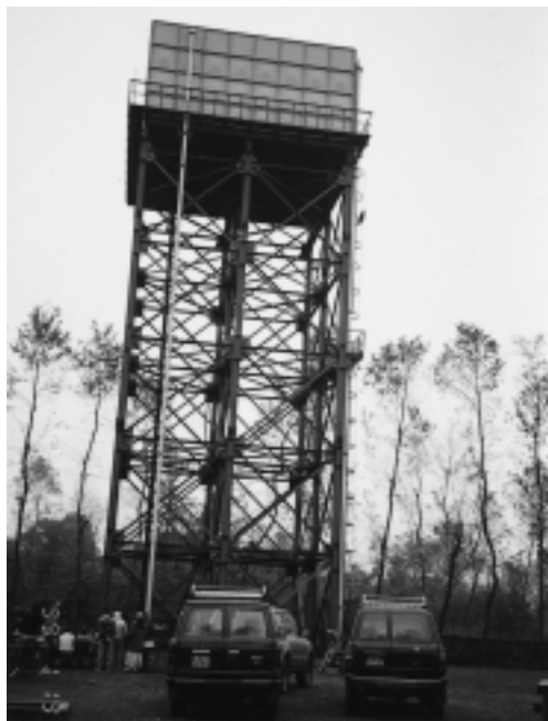
写真9 1日に1回だけ揚水される高架水槽 (Gaushara)
