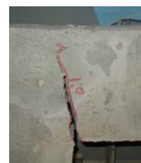
写真－４ 試験体KT 破壊状況
