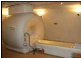
MRI設置状況
