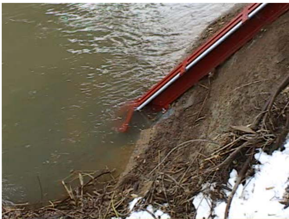
写真－１ 濁度計の設置状況（平成 17 年 2 月 23 日撮影）
