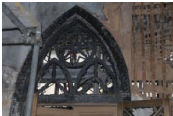
損傷したステンドグラス
