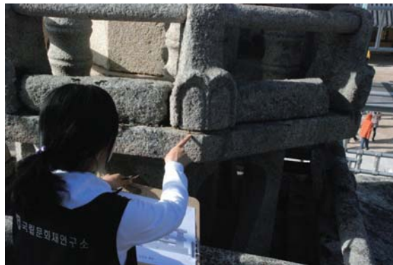
佛国寺多宝塔における病害調査
