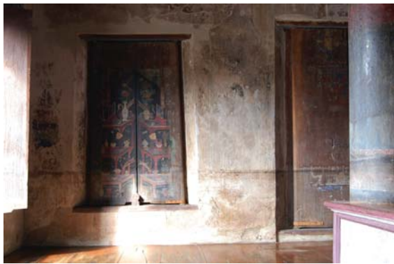
浸水によって下部が汚損した壁画の例
