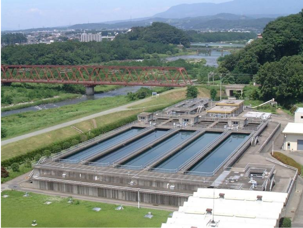
横流式沈でん池
