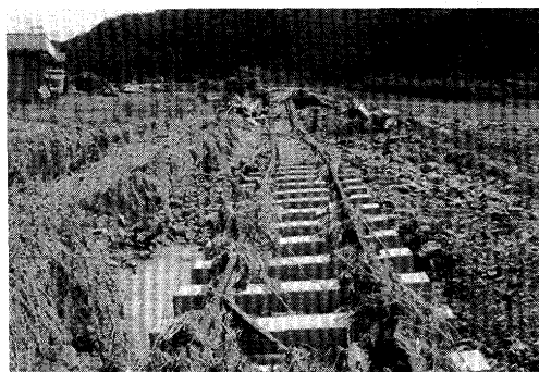
図一 線路流失の例
