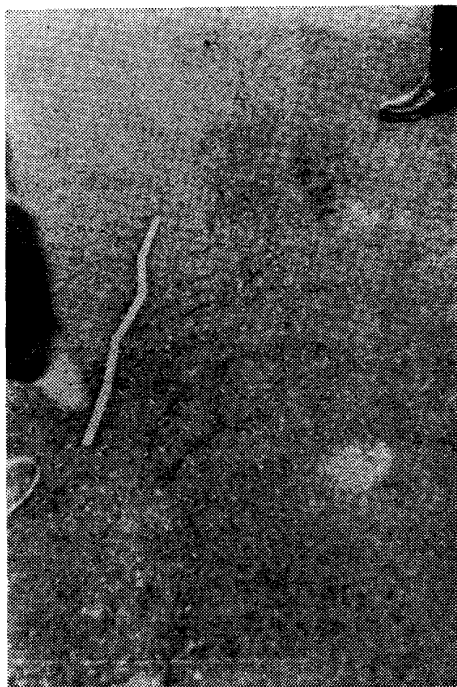
写真-3 アスコン表層に生じた流動 (写真の手前方向に走行する車線, 昭和39年12月)
