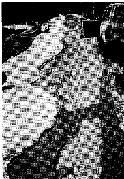
写真-1 道路の被害例
