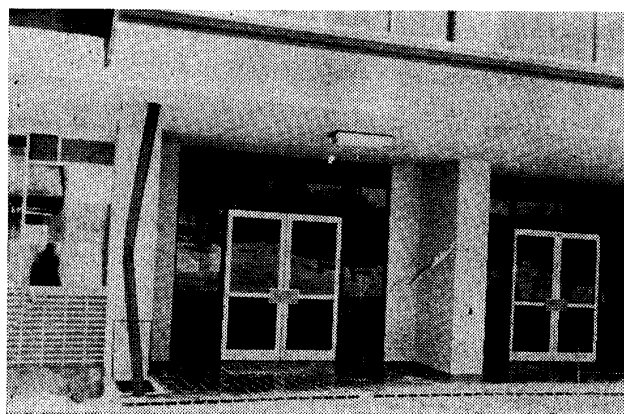
写真7.4.2 玄関ポーチの凍上による支柱の変形(昭和40年代初期)
