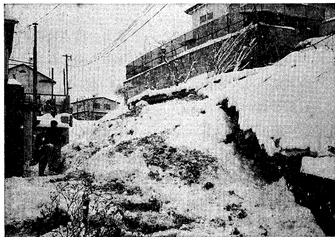
写真—2 釧路市材木町の斜面崩壊（急傾斜地崩壊危険指定地）
