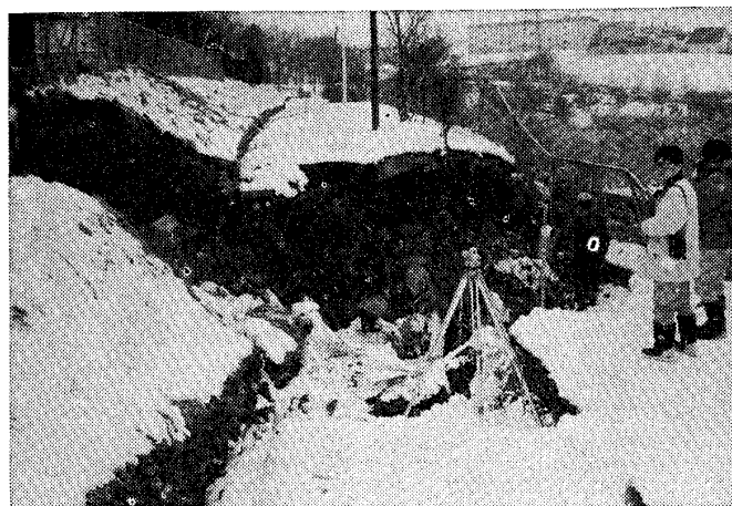
写真-1 釧路市武佐の造成地被害
