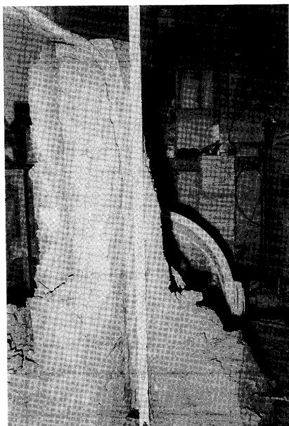
写真—2 FD材の変状状況
