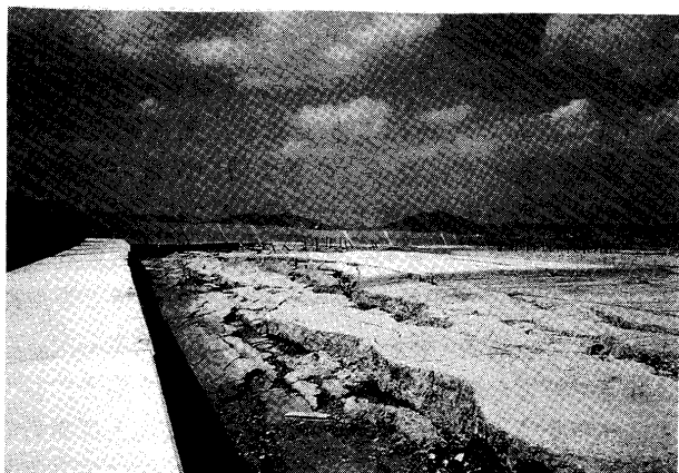
写真—4.4 護岸が地震力によって大変位した例 (ポートアイランドにて)
