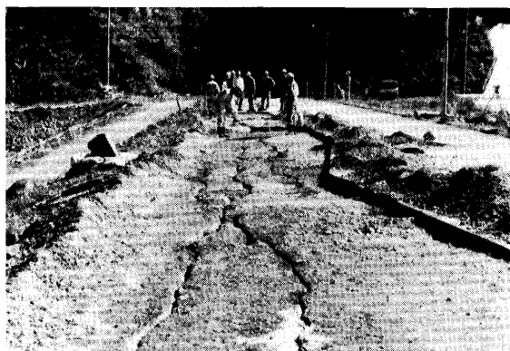
写真—7.1 天端に発生したクラック 13)
