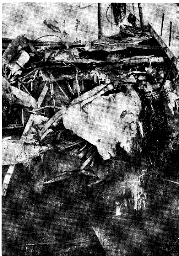
写真 2 衝突による甲板の破損 3)
