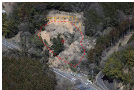
写真－2 新第三紀層（砂岩・頁岩）の流れ盤の地すべりの事例（管轄事務所提供）
