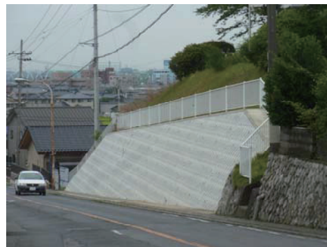
写真－1 台地縁辺部の切土のり面の石積み擁壁の変状箇所の事例（復旧後の状況）
