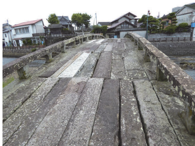
図－2 祇園橋橋桁における砂岩の板状剥離
