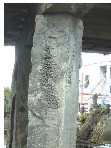
図－3 祇園橋橋脚石材におけるハニカム
