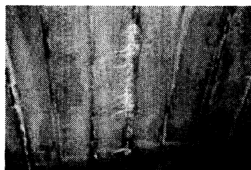
写真-3 漏水・遊離石灰
