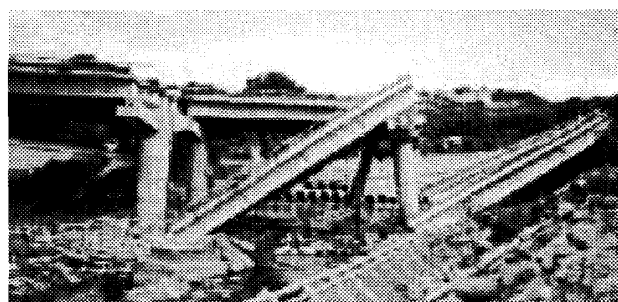
写真－1 石圍橋の被害状況
